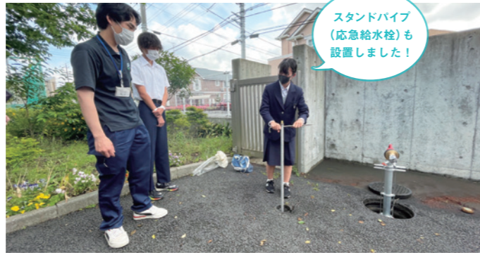
スタンドパイプ(応急給水栓)は、いざという時に敷地内にある水道管に接続し、蛇口を使い飲料水を供給します。
