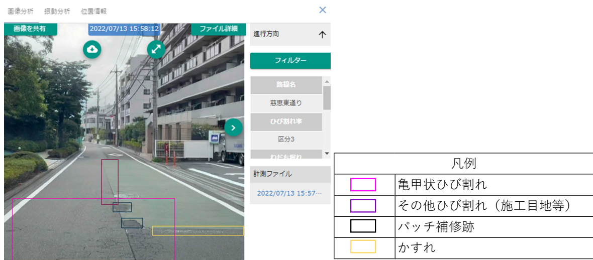
写真-1 AIが捕捉した路面の損傷状況 （市道第34号線：評価E）
