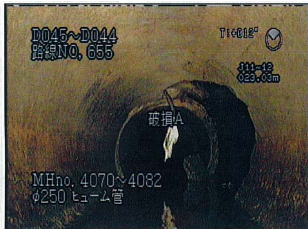
図-13.2 管渠破損の事例
