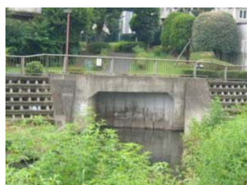
図-1.2 越流水放流渠 きよ （世田谷区）
