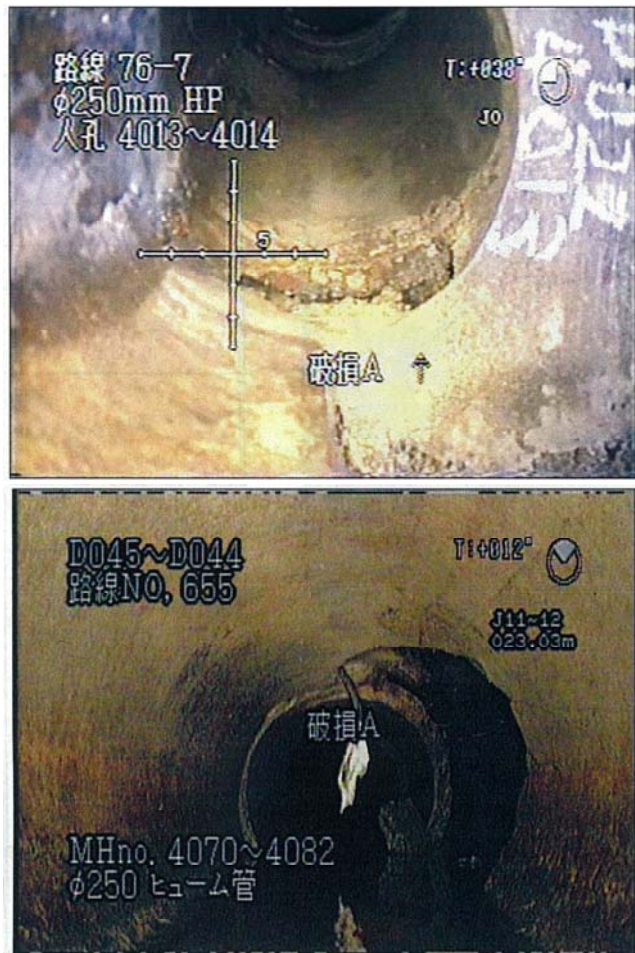
図-15.2 管渠 きよ 破損の事例
