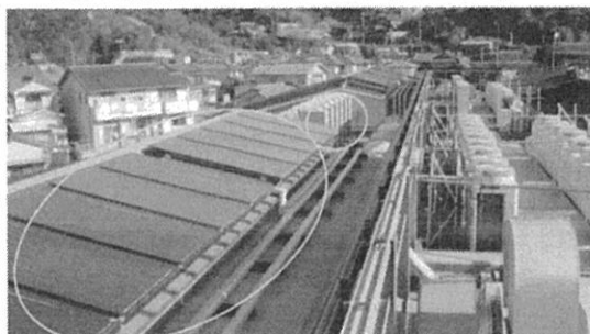
太陽熱パネルと蓄熱タンク
