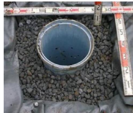
宅地内 雨水浸透ます
