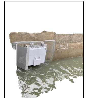
逆流防止ゲート （フラップゲート）
