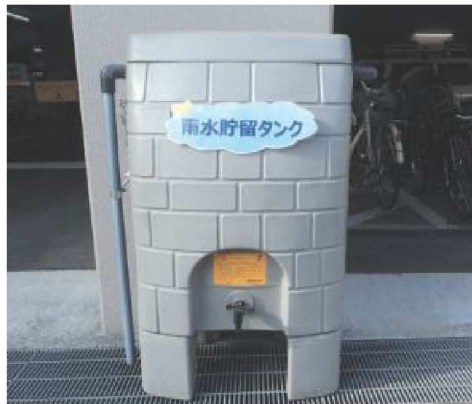
雨水貯留タンク
