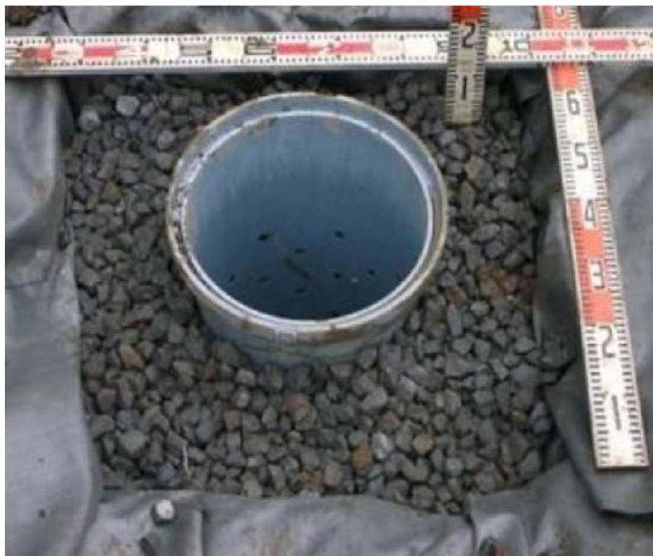
宅地内 雨水浸透ます
