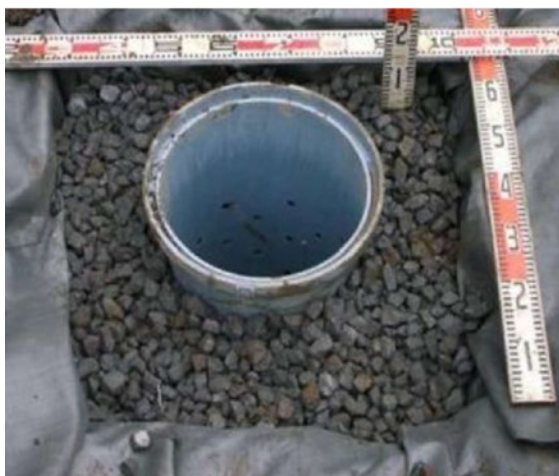
宅地内 雨水浸透ます
