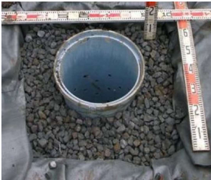
宅地内 雨水浸透ます
