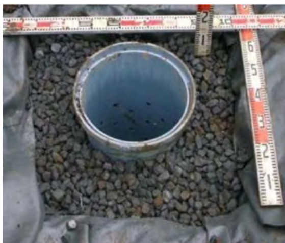
宅地内 雨水浸透ます
