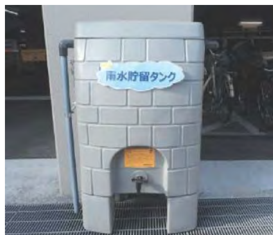
雨水貯留タンク
